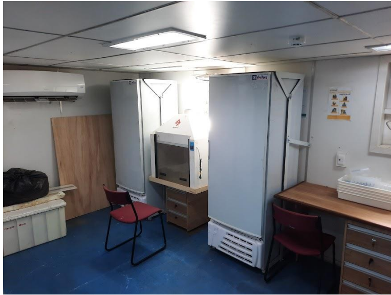
Figura 7) Capela de gases instalada no Laboratório Seco.
