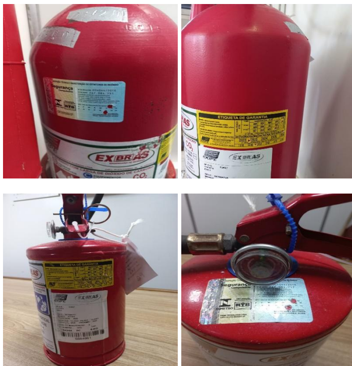
Figura 30. Modelo de Extintores etiquetados após a inspeção na embarcação.
