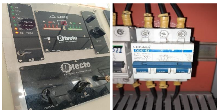
Figura 26. Disjuntor substituído e chave seletora do modo de leme.
