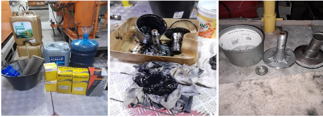
Figura 8. Serviço de manutenção dos motores: revisão dos motores de combustão principal.
